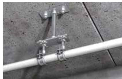
Tubazione in plastica con punto fisso
